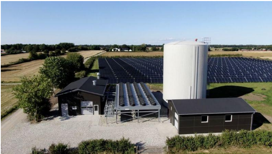
Abbildung 4-12: Heizzentrale eines wärmepumpenbasierten Wärmenetzes (Aalborg CSP, 2022)
