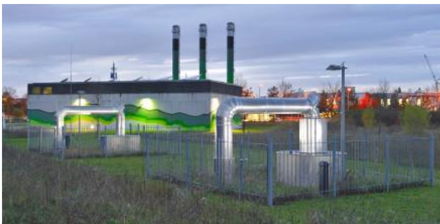
Abbildung 4-16: Geothermieanlage am Riem (SWM, 2023)
